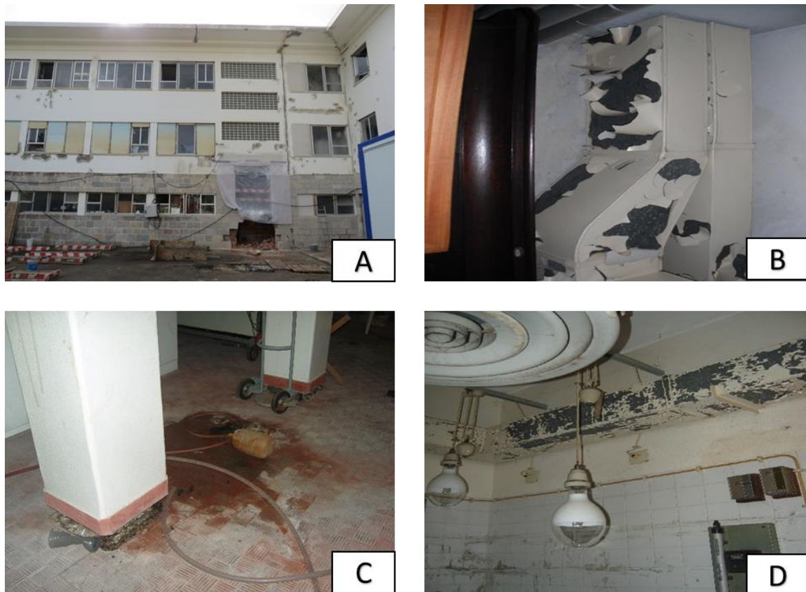
Figura 4.8: (A) Degradação da fachada; (B) Degradação de equipamentos; (C) Assentamento de pisos e (D) Degradação de sala interna
