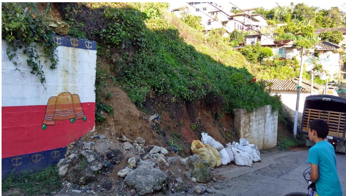
Fotografía N° 3. Talud sector barrio El Clavel
