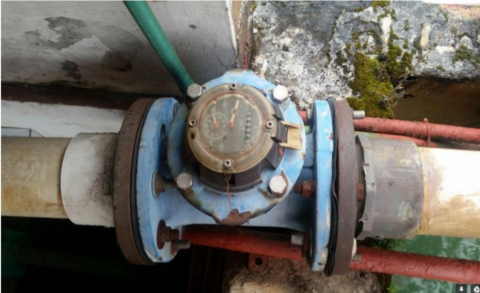
Anexo 3. Macro medidor Agua de Quebrada, Tanques de almacenamiento, (Fuente propia, 2017)
