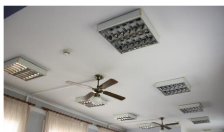
Iluminación Sala de estar: MUTUAM La Creueta
