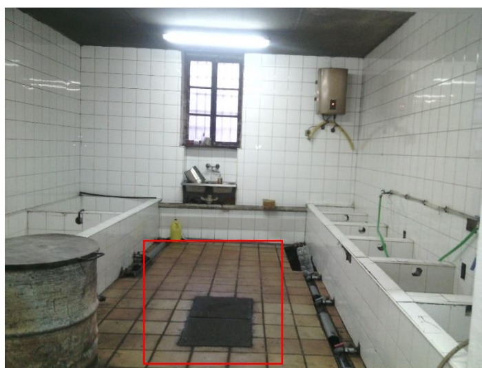
Ilustración 11: Sala de decantación, el recuadro rojo indica dónde están situados los depósitos
