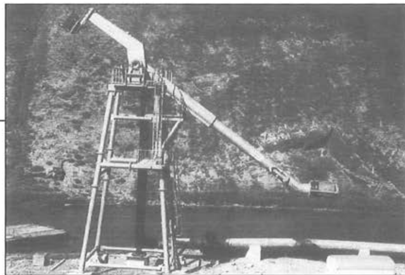
Foto 2: Waterafname op variabele hoogte (PROVAR). Photo 2: Prise à hauteur variable (PROVAR).
