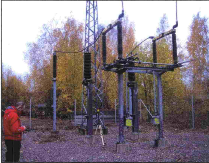
Kuva 3. Erottimien alla tehtävä sähkökentän mittaus.
