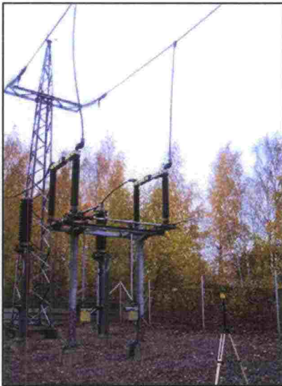
Kuva 4. Mittaustilanne 110 kV johtimien alla.
