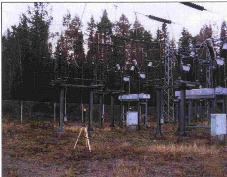
Kuva 7. Välierotin sähkökentän mittalaitteen kohdalla, taustalla Y:n muotoiset pääerottimet.
