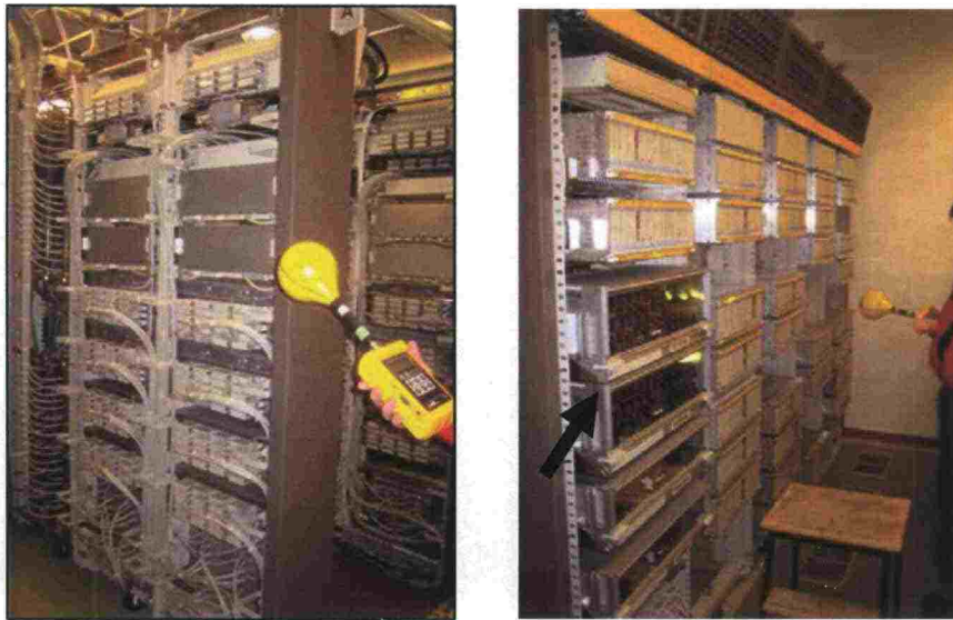
Kuva 2. Tietokoneasetinlaite Huopalahdessa. Äänitaajuusraidepiiri on merkitty nuolella oikeanpuoleiseen kuvaan.
