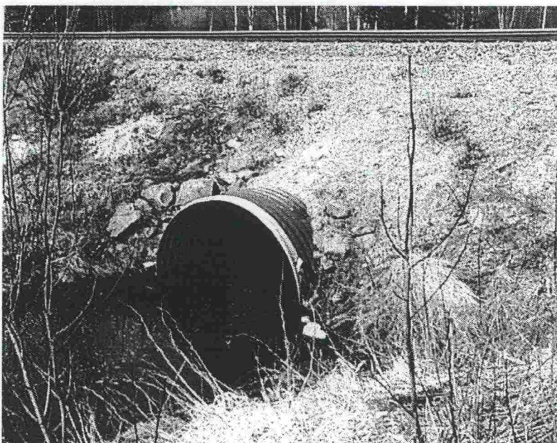
Kuva 17. 008, 842+749, Teräsohutlevyrumpu (virallisesti silta!), päällä kangas (2*huopa). Vettä meni runsaasti ( 1/3 putken korkeudesta )
