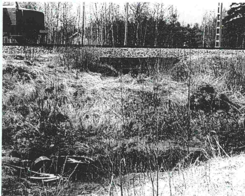
Kuva 15. 008, 742+300, Teräsputki, rumpu syvällä ja lähes täysi.
