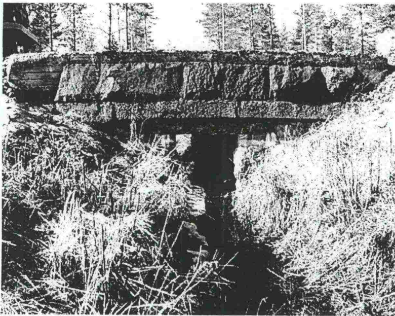
Kuva 8. 514, 714+159, Kivirumpu + betonikansi, alakansi molemmilla puolilla rapautunut alareunastaan n. 200 mm pituussuunnassa.
