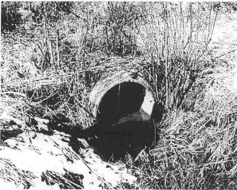
Kuva 10. 008, 704+500, Betoniputki, liikkunut ja vuotanut!
