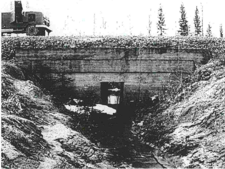
Kuva 13. 514, 720+689, Betonivalu, sepeli padottaa eteläpuolella!
