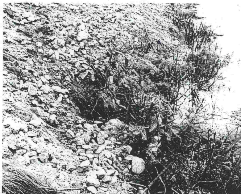
Kuva 6. 514, 714+875, Kivi/betoniputki, lyhyt molemmista päistä, jatkettava!
