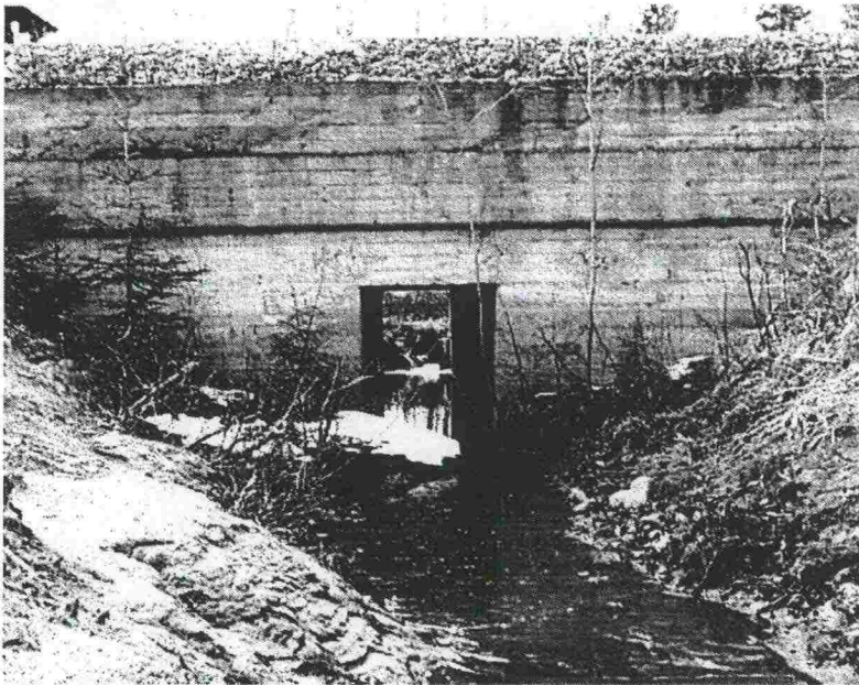
Kuva 14. 514, 720+689, Betonivalu, sepeli padottaa eteläpuolella!
