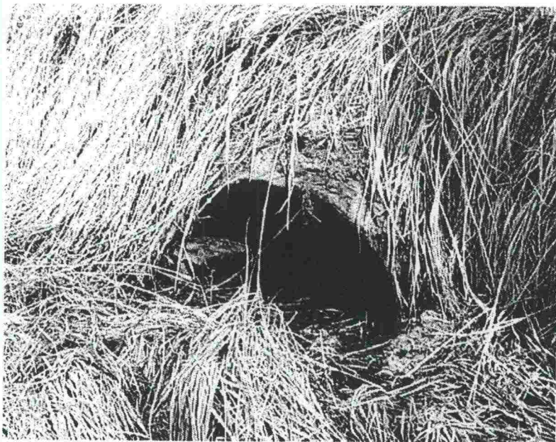
Kuva 16. 008, 744+920, Teräsputki: 15 mm:n seinämä.
