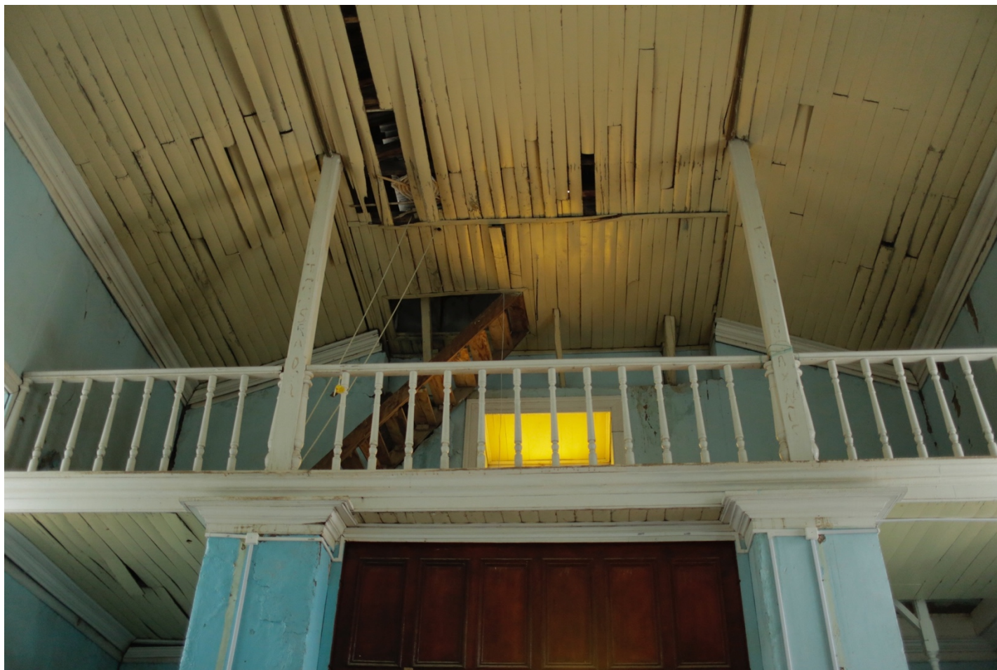
Figura 16: detalle deterioro sector campanario. Autor: Iván Maureira.
