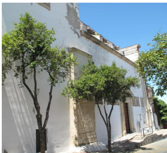
Fig. 3.- Convento de la Merced, contrafuerte de la fachada lateral. Fotografía: M a Paz Pérez.
