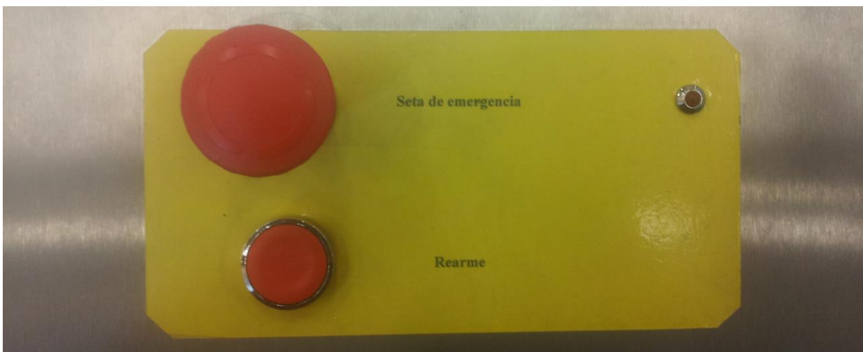
Figura 18. Panel emergencia físico
