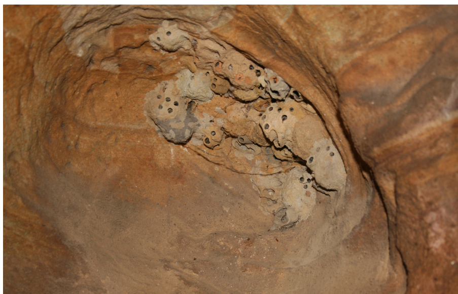
Figura 6. Superficie de la pared del abrigo afectado por nidos de avispas terreras.
