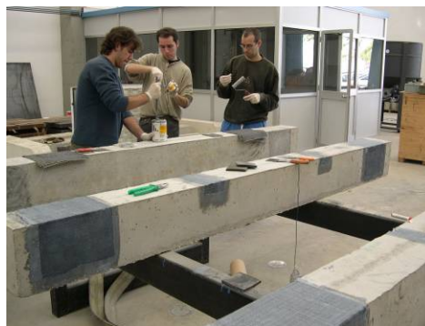
Fig. 3. Pegado de la platabanda de fibra de carbono sobre vigas de hormigón armado.
