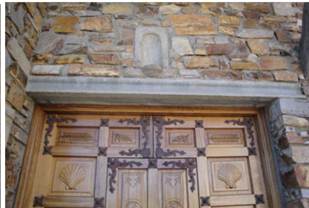
Figura 2.114. Viguetas prefabricadas en dintel de puerta de acceso. Iglesia de Santiago, Pumarejo de Tera (Zamora), 1984.
