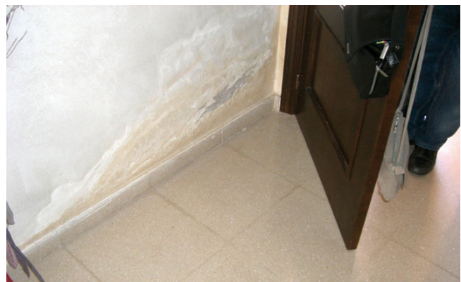
Figura 7. Humedad capilar en vivienda de planta baja.
