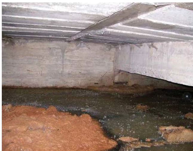
Figura 9. Embalsamiento de agua en la cámara bajo el forjado sanitario.
