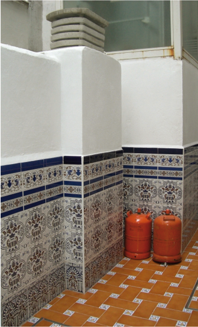
Figura 12. Conducto de extracción ubicado en el patio interior intercomunitario.
