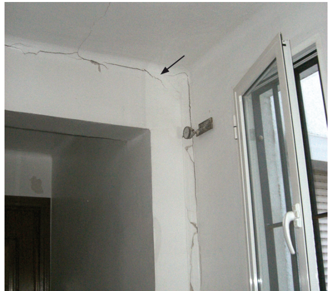
Figura 6. Grietas en caja de escalera C/ Ciudad de Onteniente 4.
