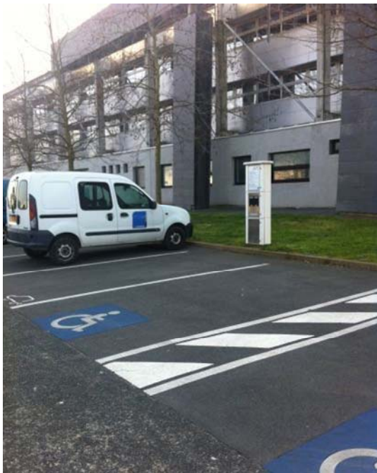
Figura 6. Punto de recarga VE Parking Universidad de La Rochelle.
