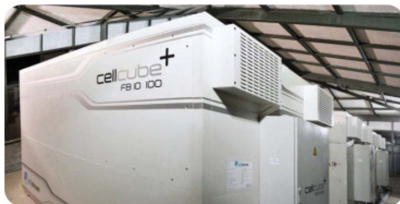
Figura 7.9. Aspecto de las baterías redox de vanadio utilizadas en India.
