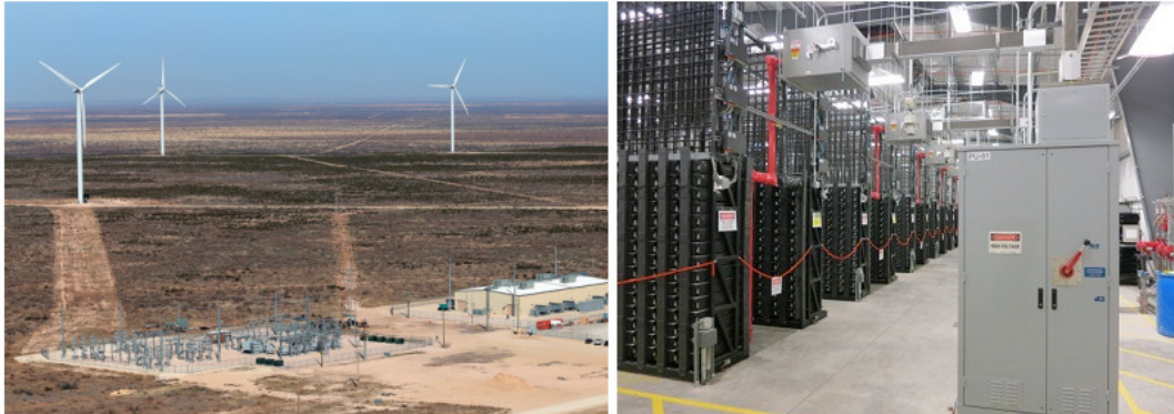
Figura 7.4. Sistema de almacenamiento con baterías de plomo-ácido en Texas.
