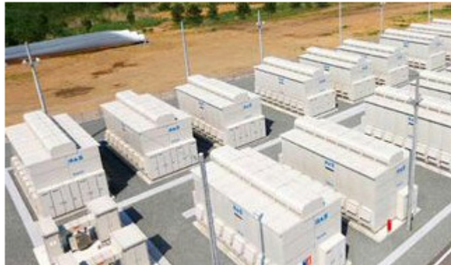
Figura 7.7. Instalación de 12 MWh de baterías de sodio-sulfuro en Japón.
