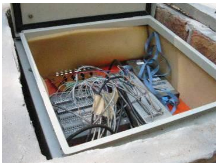
Figura 2.8: Detalle de los colectores de datos ( data loggers ) instalados en el campo.
