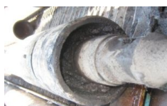
Мехпримеси в насосном оборудовании
