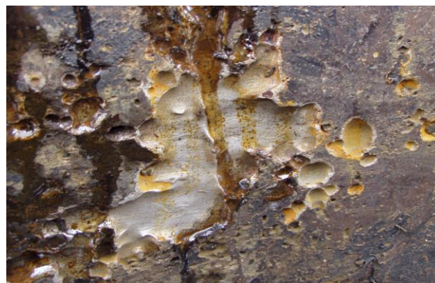
Рис. 3 Внешний вид дефекта № 1
