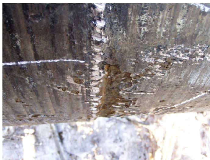
Рис. 4 Внешний вид дефекта № 6
