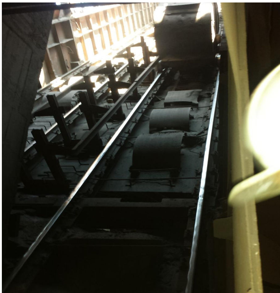
Рисунок 1.5 – Скиповый подъемник доменной печи №1
