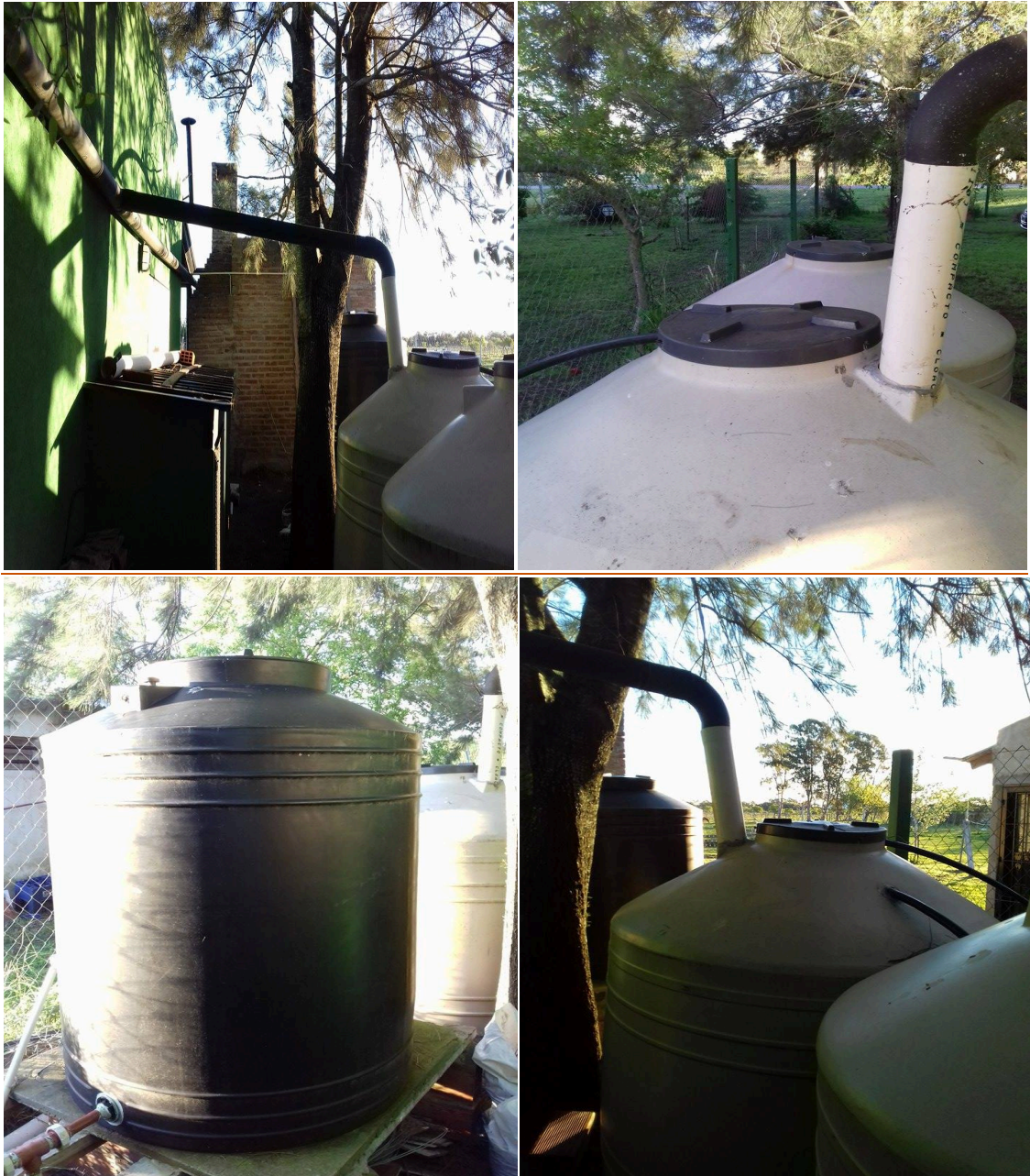
Figura N°9: sistema de recolección y reservorios reales de almacenamiento del agua de lluvia.
