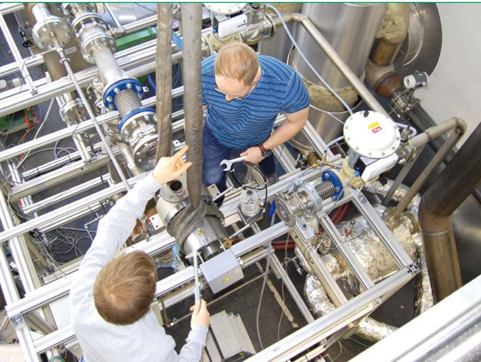
■ Abb. 5: Im Forschungskraftwerk des Zentrums für Energietechnik (ZET) der Universität Bayreuth wird eine kleine Turbine für die Stromerzeugung aus industrieller Abwärme installiert. Mit einem neuartigen Arbeitsfluid konnte ein Spitzenwirkungsgrad von nahezu 75 Prozent erzielt werden (Foto: Christian Wisfler).
