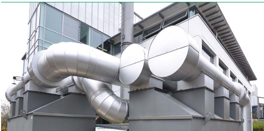
■ Abb. 4: Für Temperaturen bis 600 Grad Celsius einsetzbarer thermischer Speicher mit Sand als Speichermedium. Der Speicher ist eingebunden in ein Forschungskraftwerk auf dem Campus der Universität Bayreuth (Foto: Andreas Obermeier).
