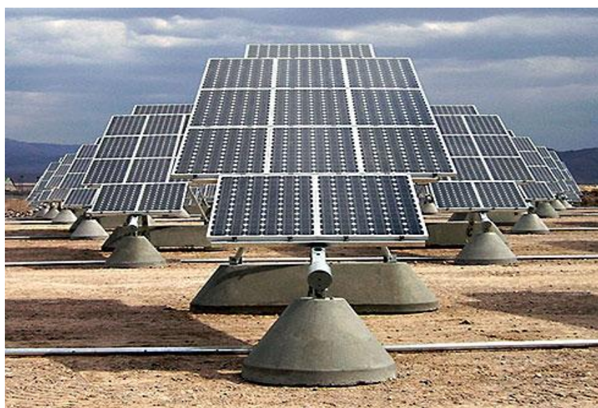
Slika 3.2: Sončne elektrarne (Vir: Google)
