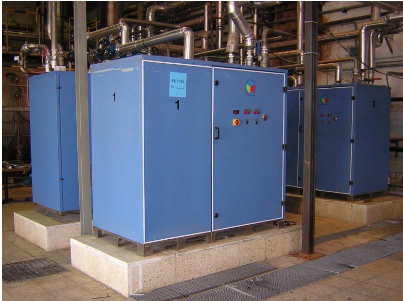
Figura 23. Equipo de pasteurizadores de agua caliente sanitaria instalados en el HUB. Fuente: archivo del Hospital Universitari de Bellvitge.
