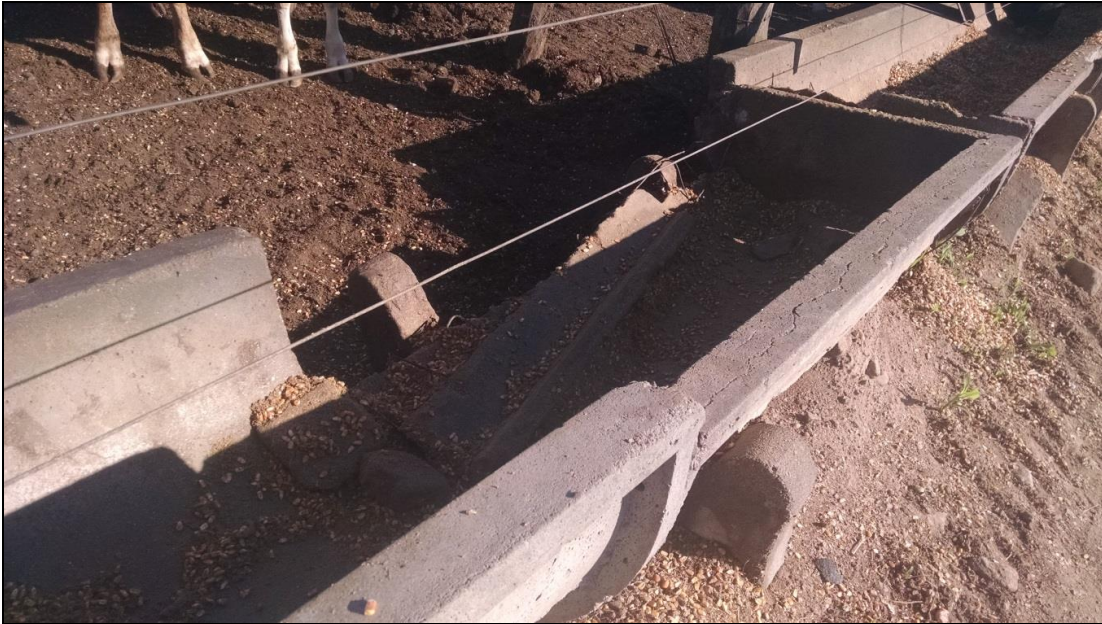
Ilustración 52: Rotura de paredes de los comederos que provoca pérdidas de la ración suministrada.
