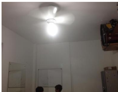
Ponto de luz e ventilador de teto
