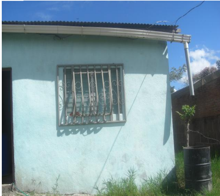
Sistema de canaleta almacenada en barril
