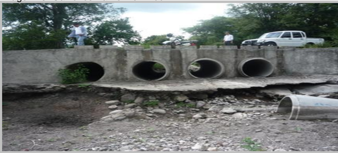
Imagen 10: Gaviones Barrio Monimbó.
