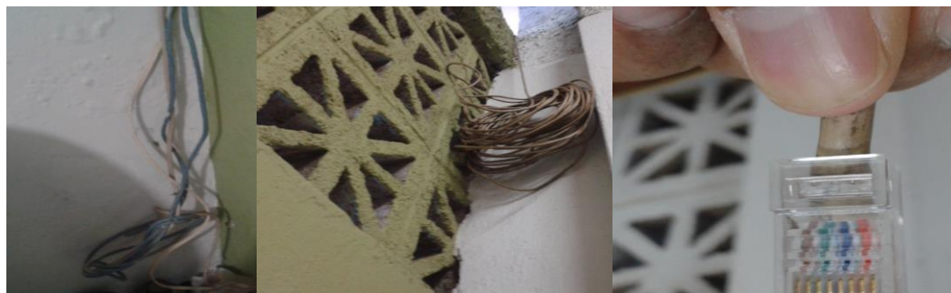
Figura 71. Componentes en mal estado.
