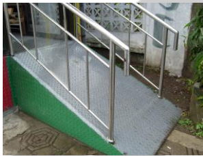
(1.a) kondisi ramp halte bus yang terlalu curam
