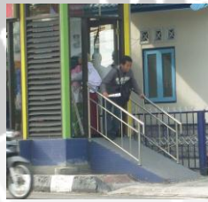
(1.b) kondisi halte bus terlalu dekat dengan batas trotoar sehingga ruang landing yang membahayakan pengguna
