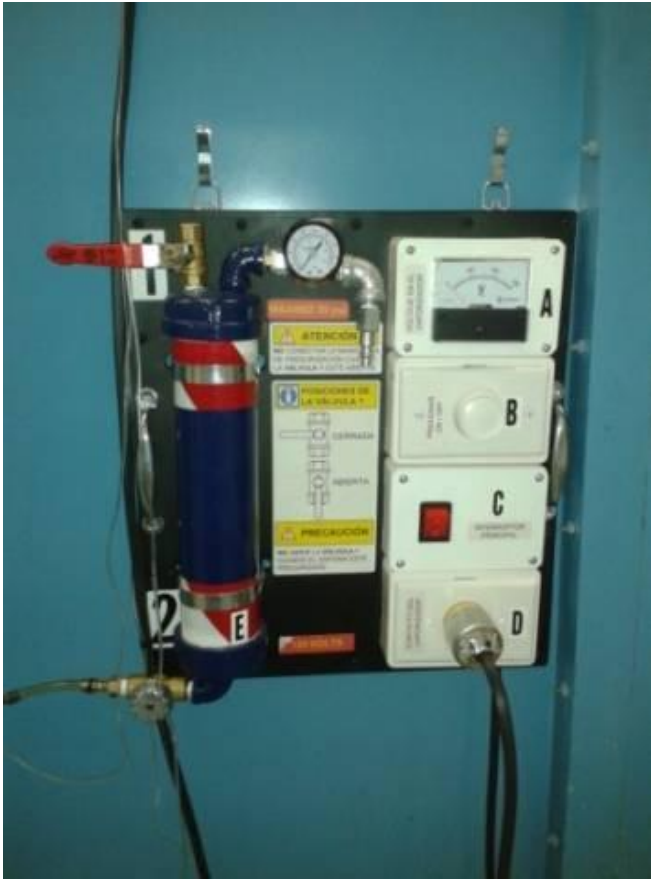
Figura 117. Sistema de Inyección de Humo
