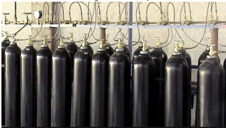
Ilustración 16. Imagen real del manifold de llenado
