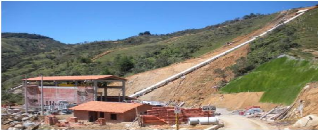
Figura 4. Casa de máquinas superficial
