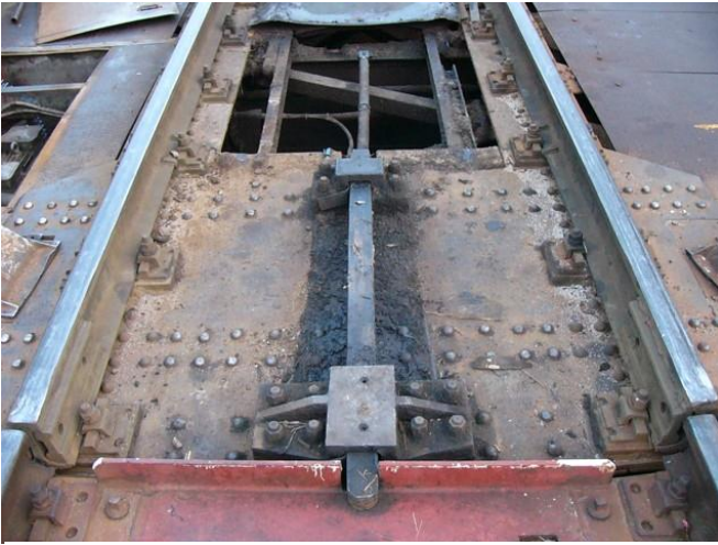
Obr. 18.: Aretační mechanismus před rekonstrukcí
