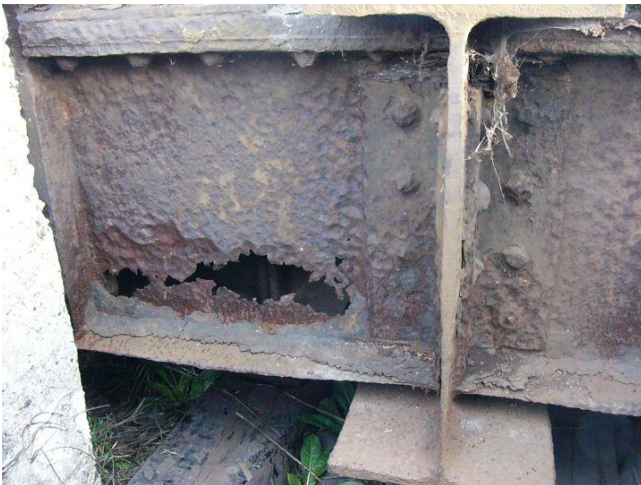
Obr. 24.: Ukázka poškozeného rámu
