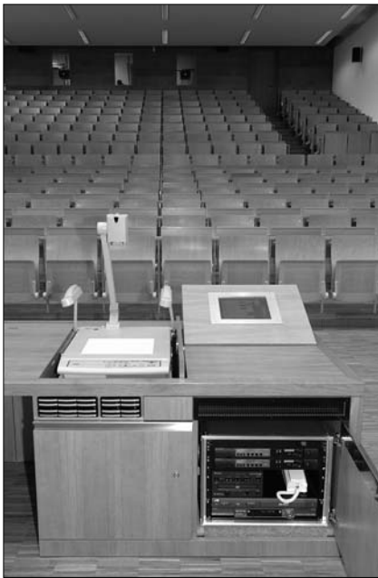
Abb. 6: Festinstallierte Medientechnik im großen Hörsaal
