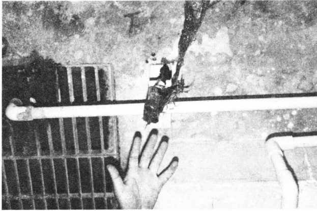
写真1 北団地水質測定室最終放流ポンプへつまった異物（58.5.24）
