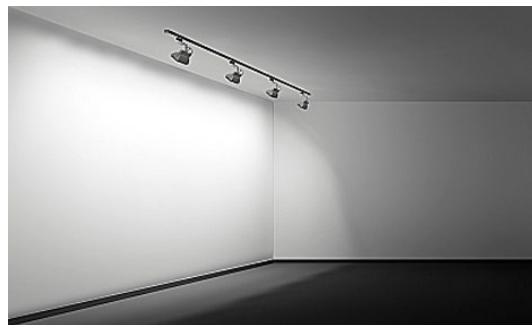
Wallwashers instalados num sistema de calhas
