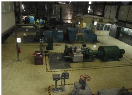
Figura 2.3: Generadores Eléctricos del Ingenio ECUDOS
