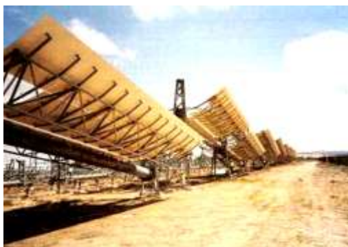
Figura N° 2.11. DSG System, 0.5Mwe
