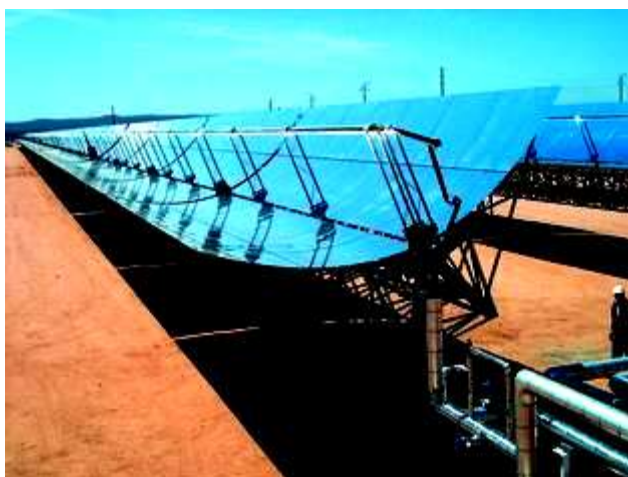
Figura N° 3.7. Colector cilindro parabólico
