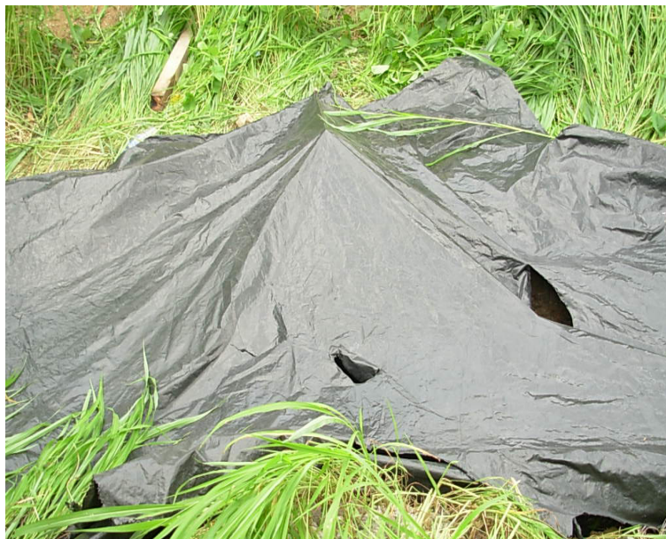
Foto 5.16.- Protección de la celda, para mantener temperatura
