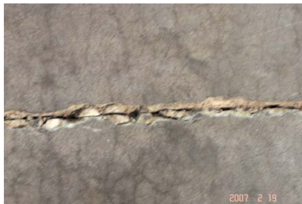
Fotografía 8. Fisura en la Junta de Contracción.
