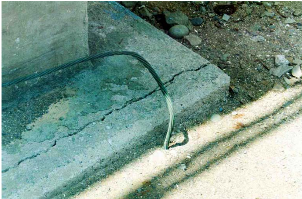
Fotografía 3. Fisura por corrosión de la armadura.
