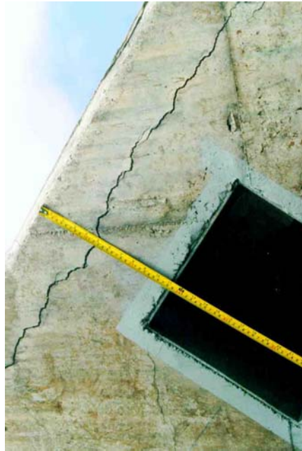
Fotografía 2. Fisura por corrosión de la armadura.
