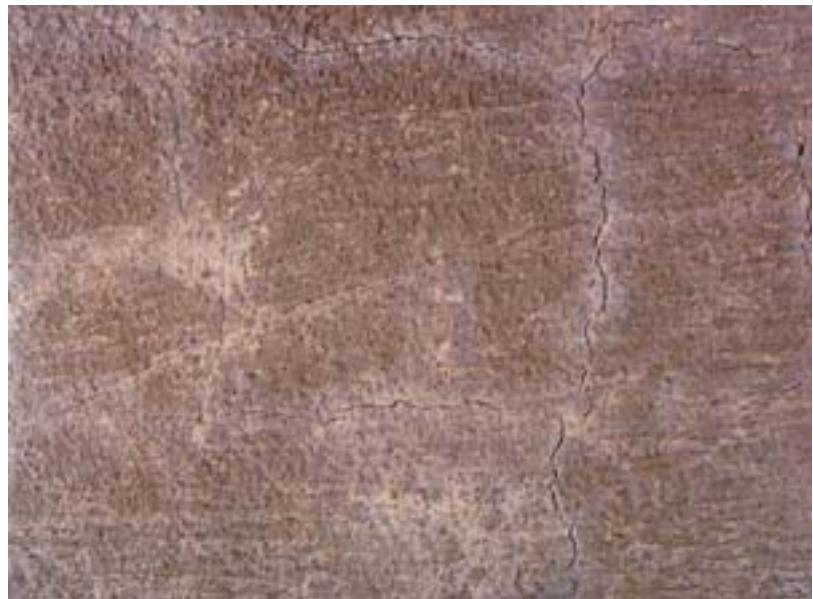
Fotografía 6. Fisura de afogado (fisuras en mapa)
