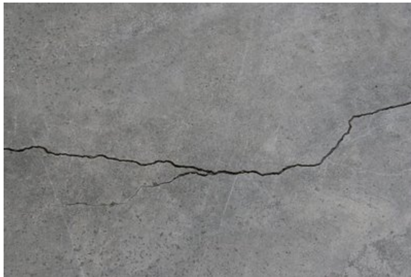
Fotografía 1. Grieta en una losa de hormigón
