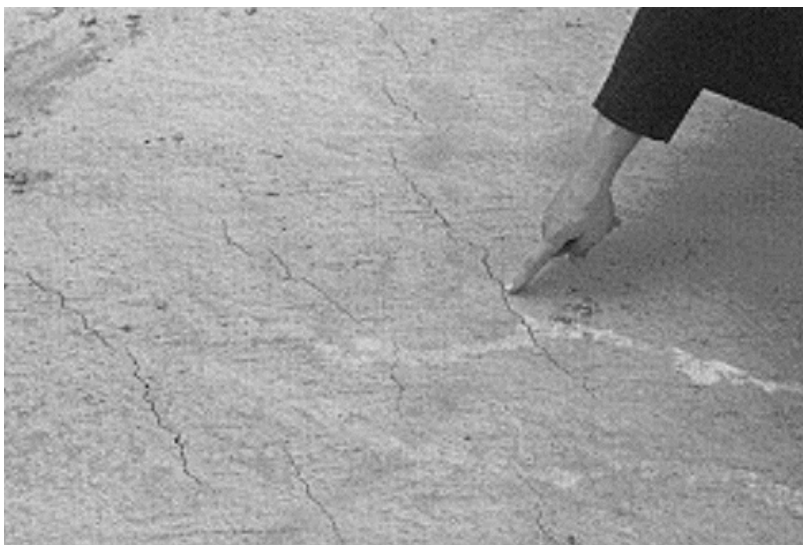
Fotografía 5. Fisura en una losa por retracción plástica
