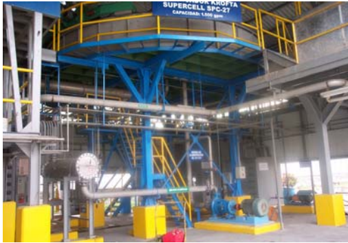
Fig. # 13: Clarificador Krofta Supercell SPC-27
