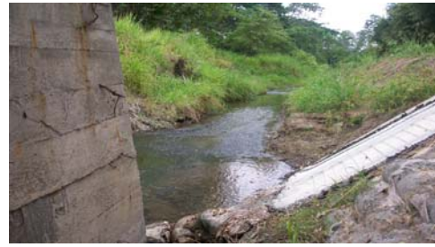
Fig # 19: Rampa de descarga al Estero SARAGUAYO
