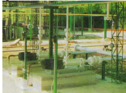
Figura 3 Bombas para el Trasiego del GLP
