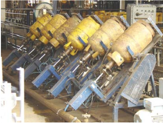
FIGURA 5. MÁQUINA VOLTEADORA DE CILINDROS LLENOS CON FUGAS PARA EVACUACIÓN DE GLP LÍQUIDO
