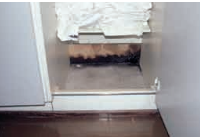
Vaurio kaapin takaseinässä.
