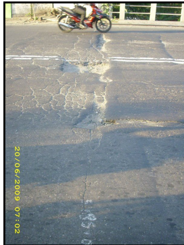
Gambar 5. Kerusakan Jalan yang Banyak Dijumpai di Jalan Ki Mangun Sarkoro. Diambil Tanggal 20 Juni 2009, Pagi Hari.
