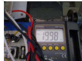
Gambar 24 Tegangan Input Rectifier atau Tegangan Sekunder Travo (Vac)
