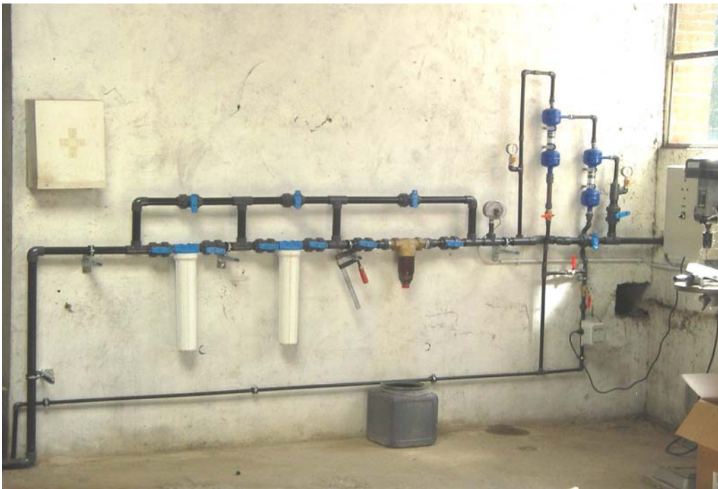
Figure II. 3. Photo du système de filtration de l'eau de Garonne [Bercovitz, 2006].
