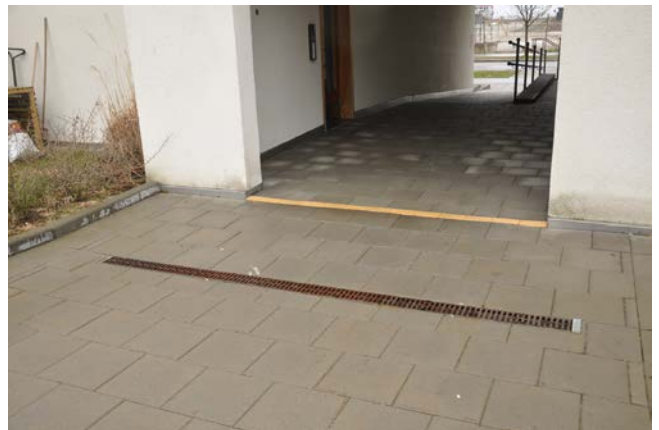
Dagvattnet leds till brunnar, här i form av ACO drain-rännor.
