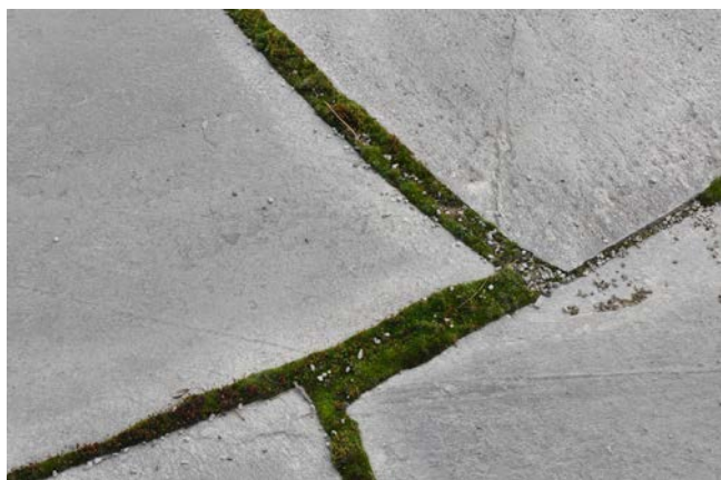
Avrinning från hårdgjorda markytor utgör en stor del av det vatten som inte kan infiltrera ner i marken. Att ha genomsläppliga fogar ökar genomsläppligheten.
