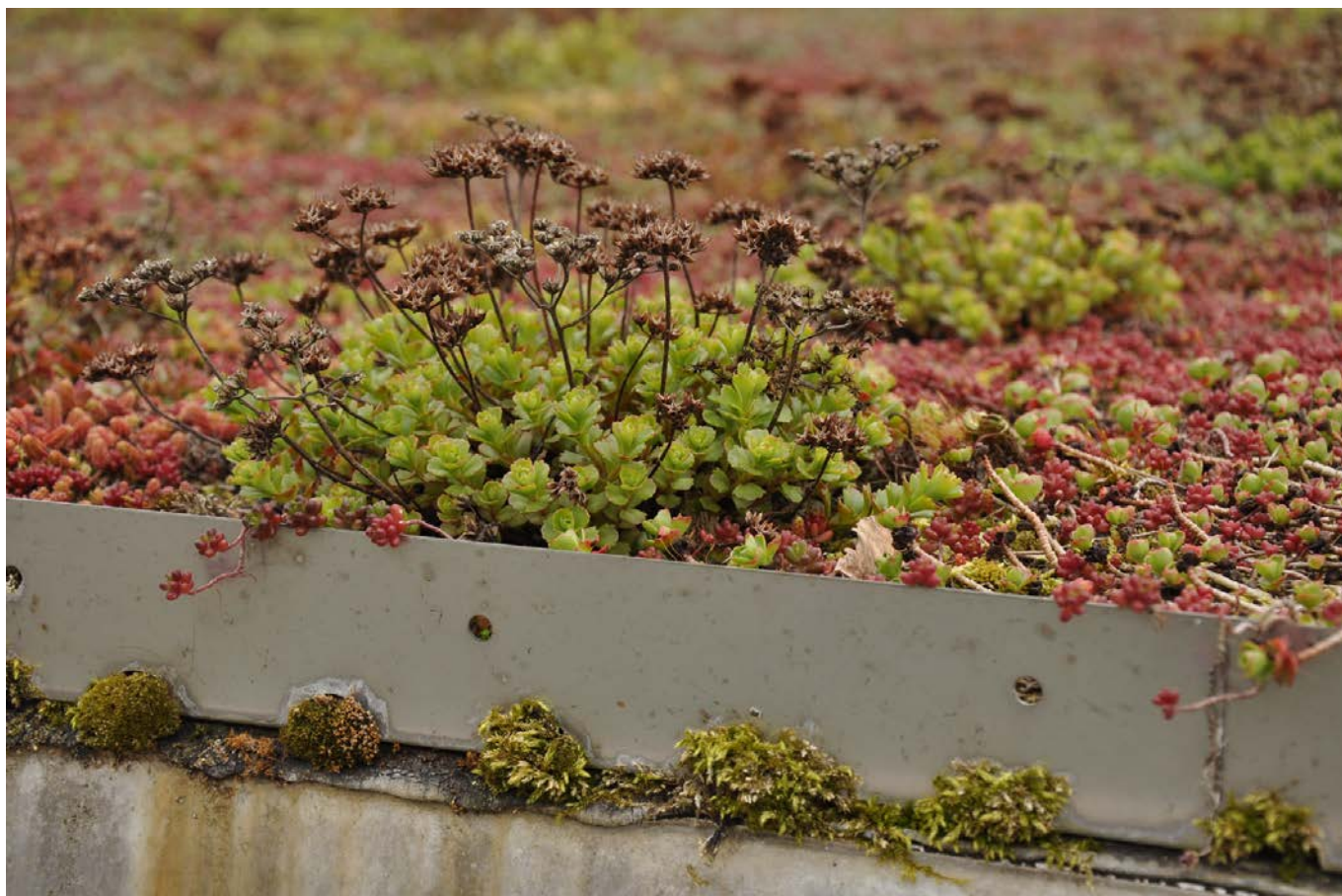
Takbeläggningar utgör en stor andel av stadens hårdgjorda ytor, därför är gröna tak ett bra sätt att sänka lufttemperaturen. Eftersom utrymmet i städer ofta är begränsat är gröna tak ett sätt att få in grönska i områden som redan är tätbebyggda.
