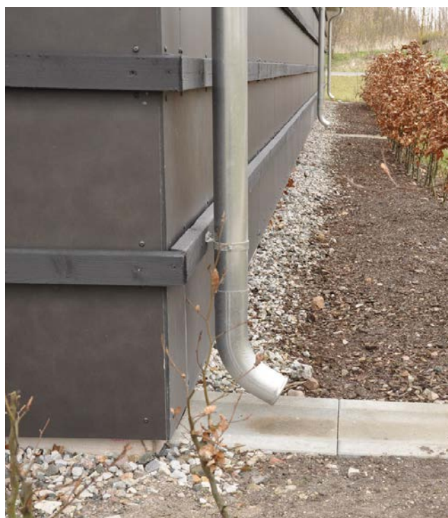
På stuprören utnyttjas utkastare som leder dagvattnet från taken till omgivande infiltrationsytor.
