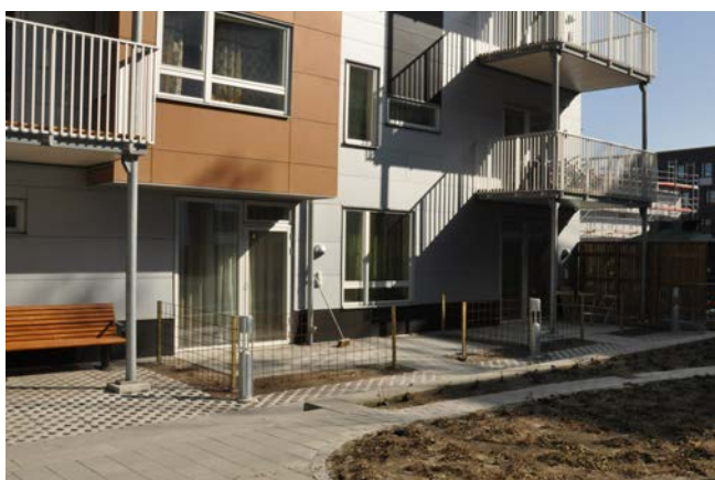
De privata uteplatserna skärmas av med hjälp av armeringsnät, vilka är tänkta att täckas in i klätterväxter. Avgränsningen och zoneringsen är ej tillräcklig för att dessa ska upplevas som privata.
