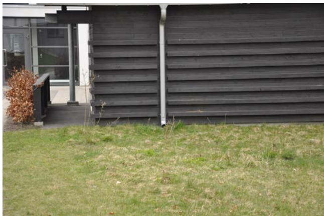
På parkeringsgaragen finns stuprör med utkastare som leder dagvattnet till omgivande infiltrationsytor.
