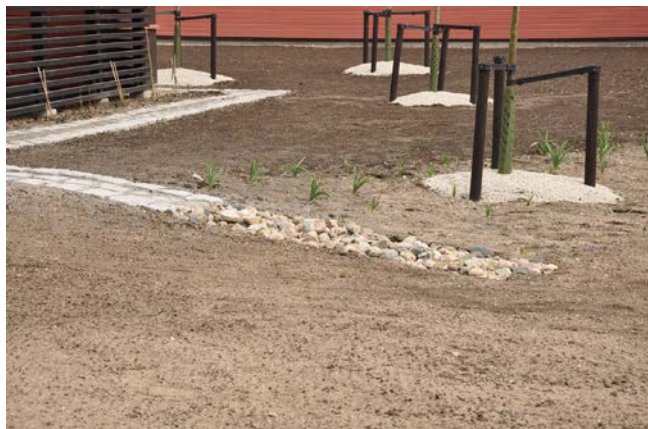
Rännalar leder vattnet från tak och hårdgjorda ytor ut till omgivande vegetationsytor.
